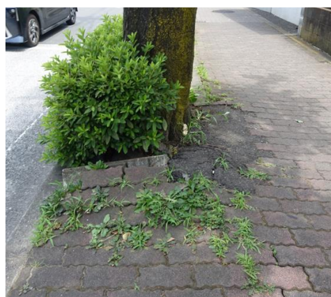
根上がりによる歩道の盛り上がり （2号線：桜街道）
