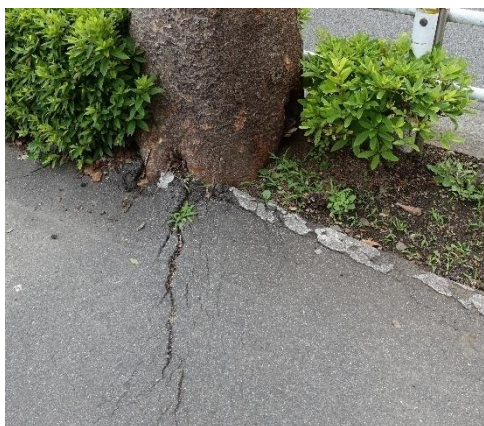
根上がりによる歩道舗装への侵食 （3号線：けやき通り）
