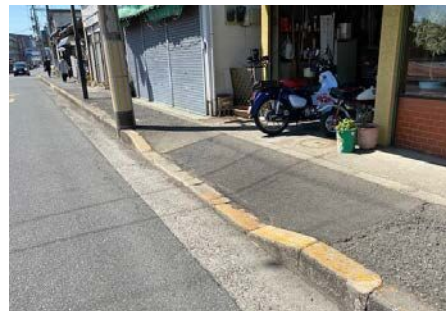
歩道が狭く波打っている用水北通り
