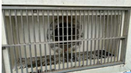
二重構造の排（環）水口
