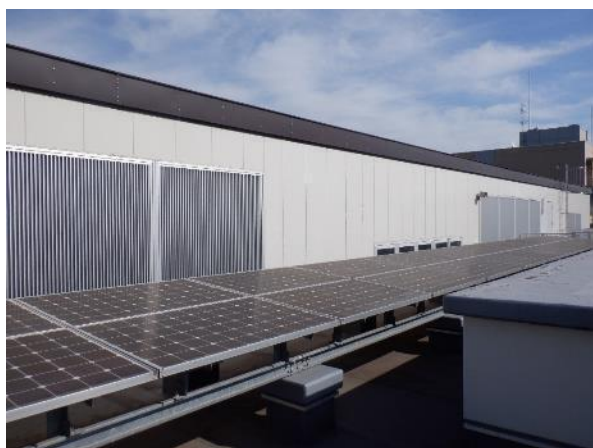
学校給食センターの太陽光パネル
