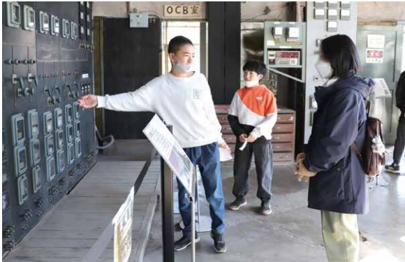
▲変電所でガイドを行う児童の様子
