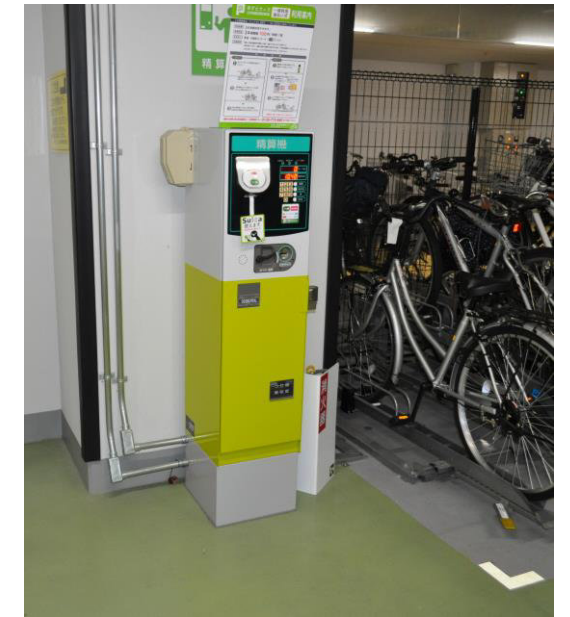
⑥電磁ロック式駐車場精算機（一時利用）
