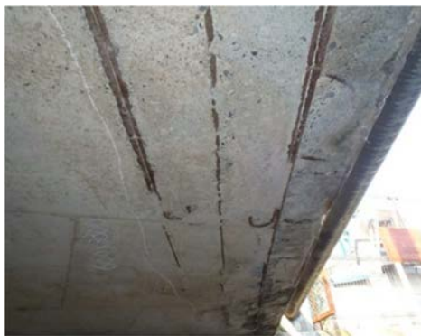
図 3-211 鉄筋が露出・腐食した橋 (高木3丁目「宮前二の橋」)
