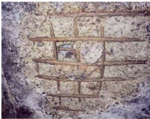
図 3-216 コンクリートが腐食し鉄筋が露出した管渠
