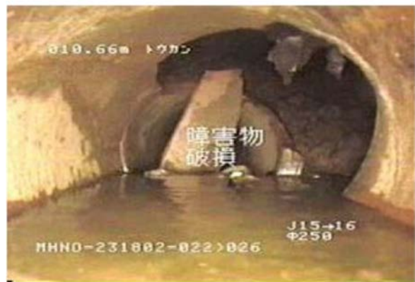
図 3-217 破損した管渠
