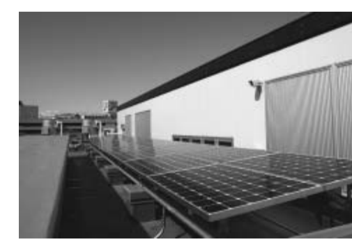
屋上の太陽光発電パネル
