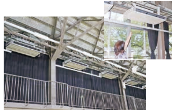
▲第一中学校体育館に設置されたエアコン
