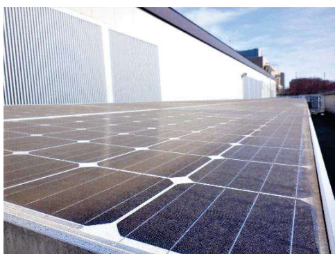
学校給食センターの太陽光パネル
