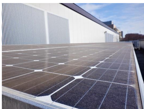
学校給食センターの太陽光パネル
