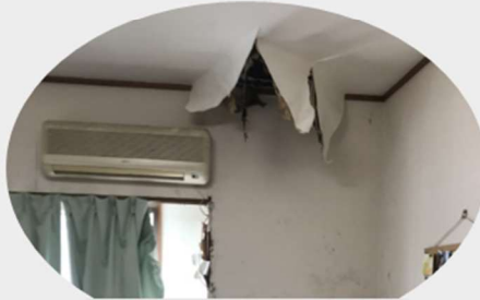
アライグマによる家屋侵入による建物の破損
