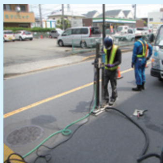
道路の空洞化調査
