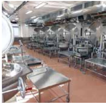
東大和市学校給食センター内の煮炊き調理室
