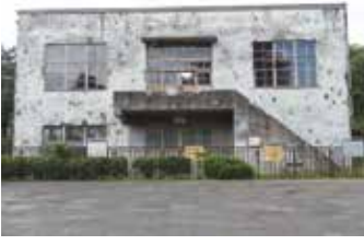
旧日立航空機株式会社変電所
